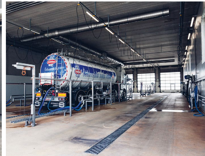
Auch das Abwasser der Waschanlage geht direkt in die eigene Kläranlage.
